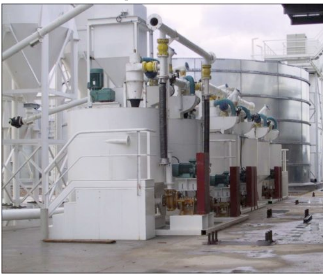
Main bentonite preparator « Bentomix »
